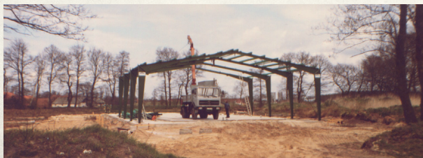
▲ 1981: Bau der ersten Fertigungshalle im neuen Industriegebiet und Umzug von Harkebrügge nach Ramsloh.
